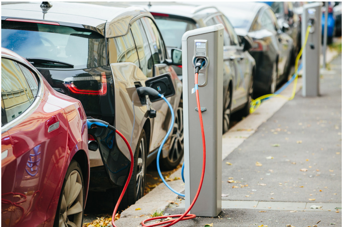
Öffentliche Ladesäule mit zwei Ladepunkten.
